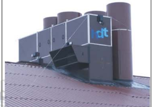
Bild 2: Die Ventilatorgruppe mit hdt-MFK Wärmetauscher auf dem Hähnchenmaststall
