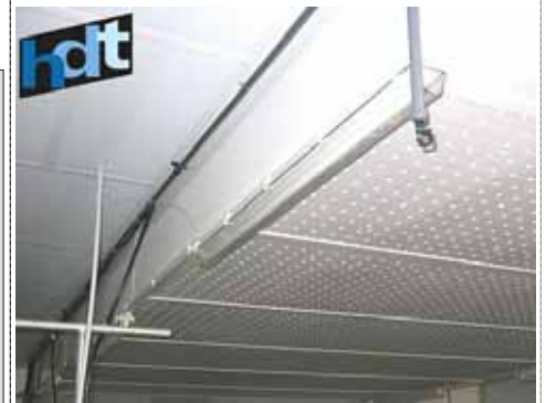
Bild 5: Zuluftkanal mit PU-Decke 60mm
