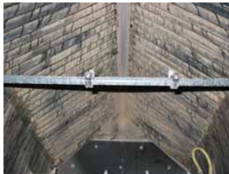
Bild 12: eine drei Jahre alte Anlage mit automatischer Wäsche, die noch nicht manuell gereinigt wurde
