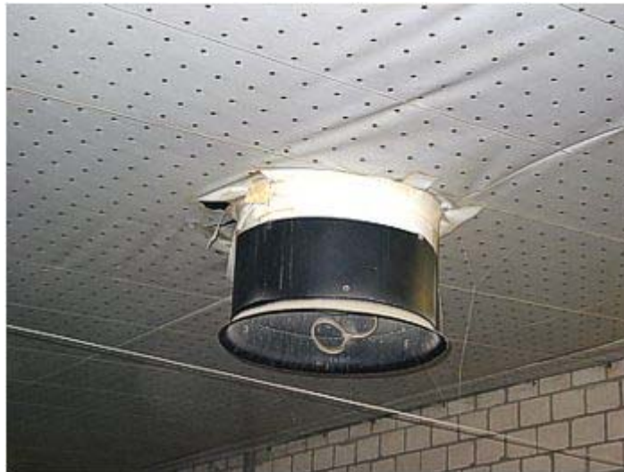
Foliendecke mit groben Fehlern, wie zu geringer Abstand des Ansaugstutzens zur Folie und große Löcher am Abluftkamin
