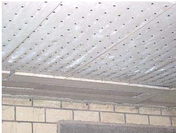
Foliendecke mit provisorisch nachträglich eingebrachter dichter Fläche an der Wand. Leider ohne den gewünschten Erfolg. Deutlich sichtbar die Wassertropfen, die unterhalb der Decke hängen und immer wieder in die Bucht und auf die Tiere tropfen. Der Luftschleier-Effekt setzte sich hier trotz der dichten Platte an der Wand fort und führte zu starken Problemen in den Buchten. Wenn Folie zum Einsatz kommen soll, dann nur mit Aufbereitung, d.h. Anwärmen der Zuluft.
