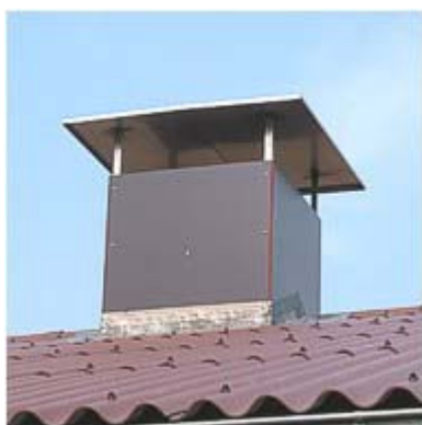
Steiggeschacht mit Regelklappe über Dach
