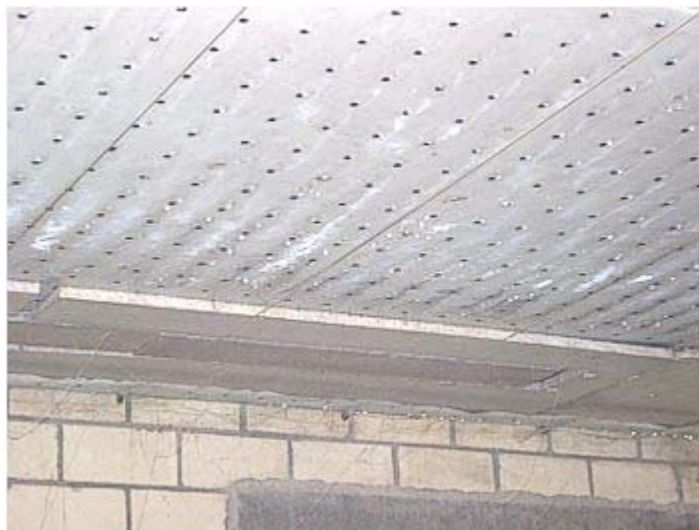
Foliendecke mit provisorisch nachträglich eingebrachter dichter Fläche an der Wand. Leider ohne den gewünschten Erfolg. Deutlich sichtbar die Wassertropfen, die unterhalb der Decke hängen und immer wieder in die Bucht und auf die Tiere tropfen. Der Luftschleier-Effekt setzte sich hier trotz der dichten Platte an der Wand fort und
