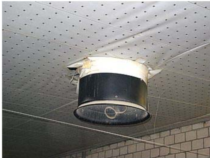
Foliendecke mit groben Fehlern, wie zu geringer Abstand des Ansaugstutzens zur Folie und große Löcher am Abluftkamin
