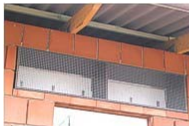
Außeneinspeiseklappen, die die Sommerluft direkt in ein Endmastabteil leitet. Hier ist auf eine gute Abdichtung zu achten.
