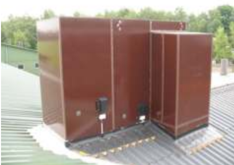
Bild 10: Wärmetauscher auf einem Sauenstall
