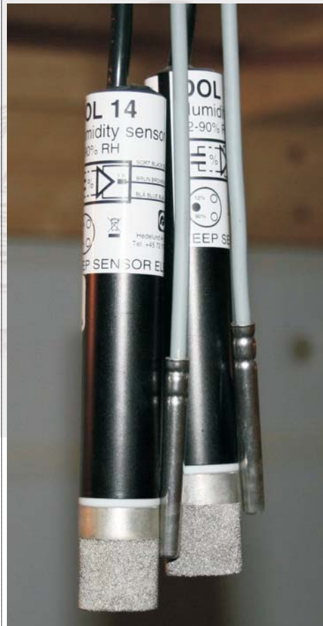
Bild 1: zwei Feuchtesensoren im Zuluftkanal
